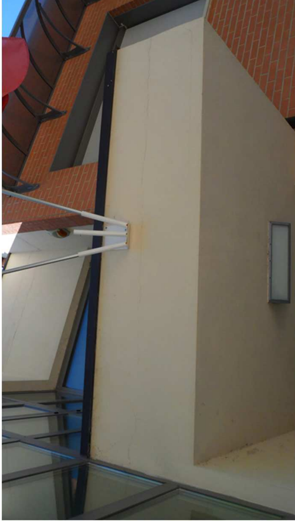
Lesione sull'ingresso principale
