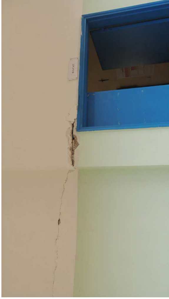
Lesione sull'architrave di una porta di un aula
